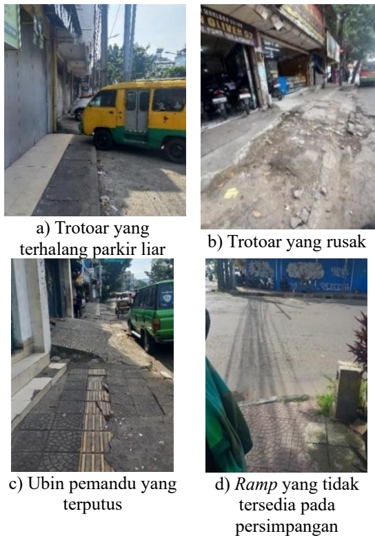
Gambar 2. Kondisi Trotoar Jalur Pedestrian di Jalan Astanaanyar Sumber: Foto Survei, 2025
