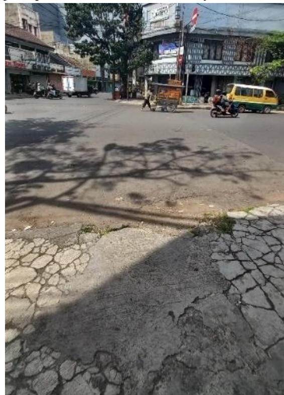
Gambar 6. Kondisi Jalur Penyeberangan Pejalan Kaki Pada Jalur Pedestrian di Jalan Astanaanyar Sumber: Foto Survei, 2025
