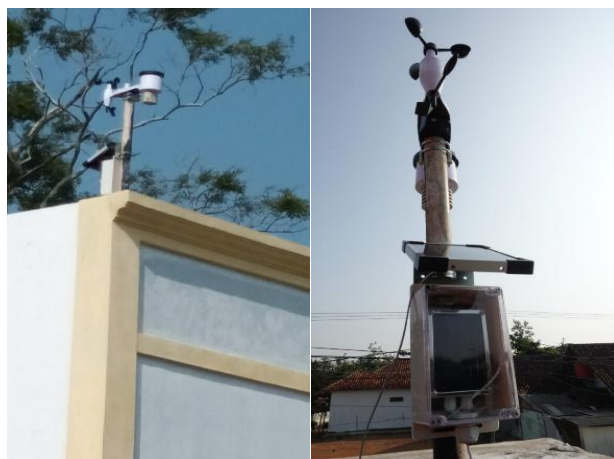
Gambar 4 Pemasangan Automatic Weather Station di Kantor Desa Pangumbahan.
