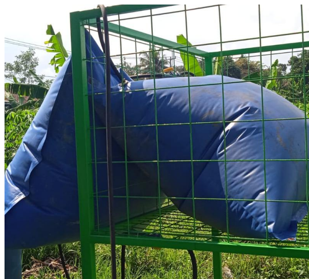
Gambar 10 Penampung biogas yang sudah penuh.
