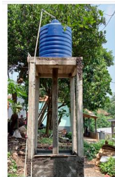
Gambar 5 Instalasi air berupa menara penampungan air dengan volume 1.050 L yang menampung air bersih hasil pompanisasi Kampung Pabuaran Desa Ciaruteun Ilir
