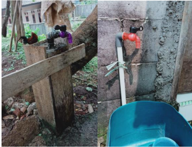
Gambar 6 Instalasi pipa dan kran air yang sudah terpasang hasil pompanisasi di rumah warga
