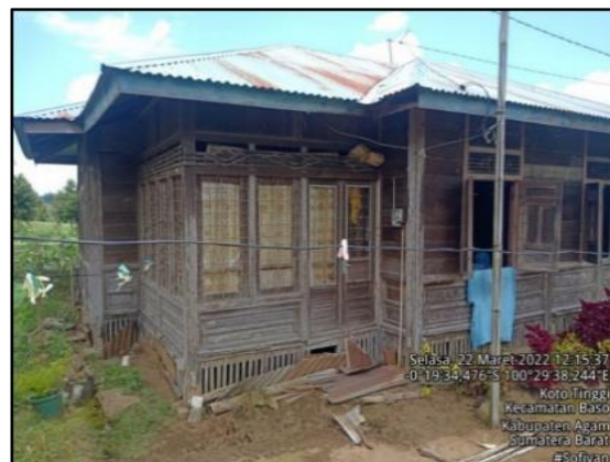
Gambar 3. Foto Rumah Tidak Layak Huni Sumber: Disperkim Kabupaten Agam, (2023)
