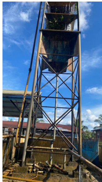
Gambar 7. Menara Aerasi pada WSS Saliki
