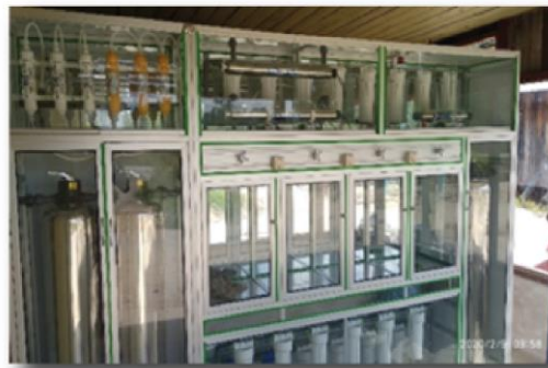
Gambar 10. Sarana Pengolahan air RO
