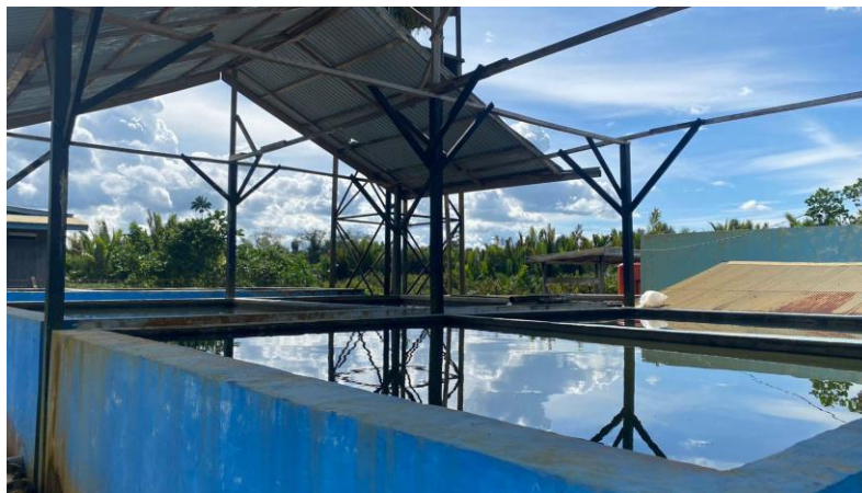
Gambar 9. Bak Pengendapan/Reservoir Pada WSS Saliki
