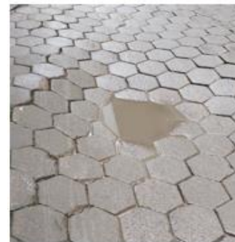
Gambar 3. Kondisi fasilitas trotoar
