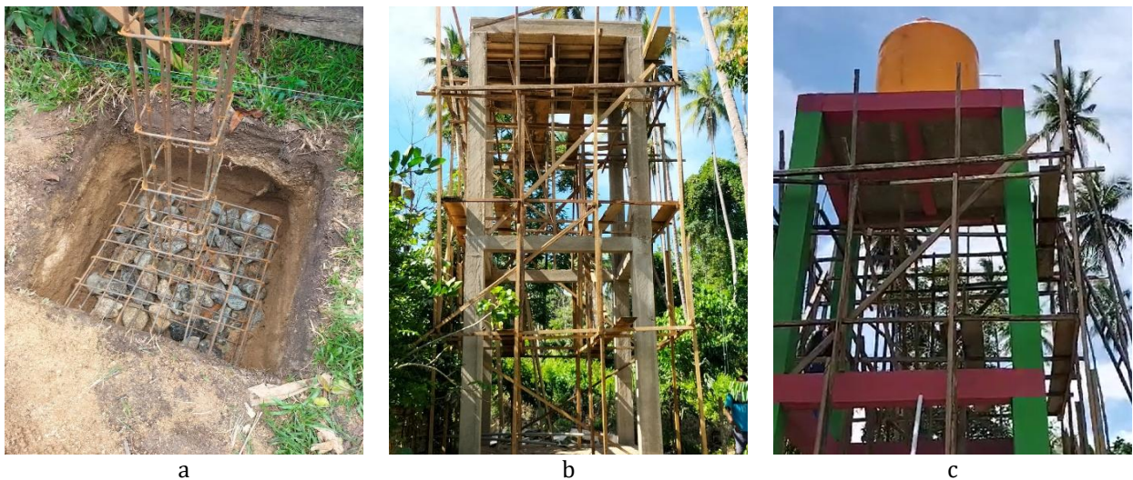
Gambar 5 Konstruksi menara air dan penyambungan pipa ke jaringan penyediaan air Desa Wai U, a) Konstruksi pondasi, balok, dan kolom, b) Konstruksi hingga lantai-2, dan c) penempatan toren di atas menara.
