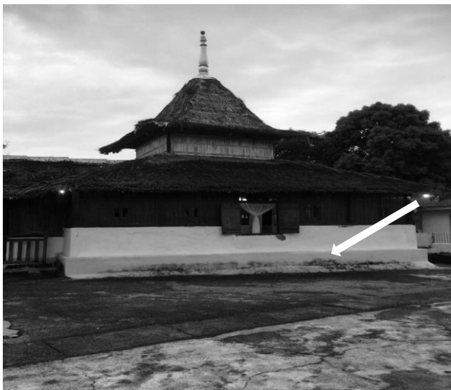
Gambar 5 Perubahan warna dinding akibat kelembapan tinggi.
