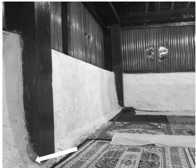
Gambar 6 Potensi kelembapan tinggi di fondasi di ruang utama masjid.
