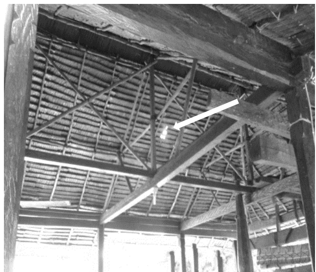
Gambar 7 Terlihat ada lubang di atap teras belakang.
