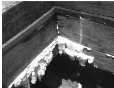
Gambar 2 Busa polyurethane keluar dari celah-celah dinding karena adanya tekanan saat proses pengembangan
